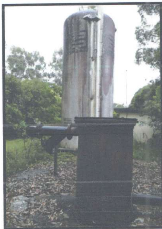
Figura 11 – Vista do poço de Água Bruta.
