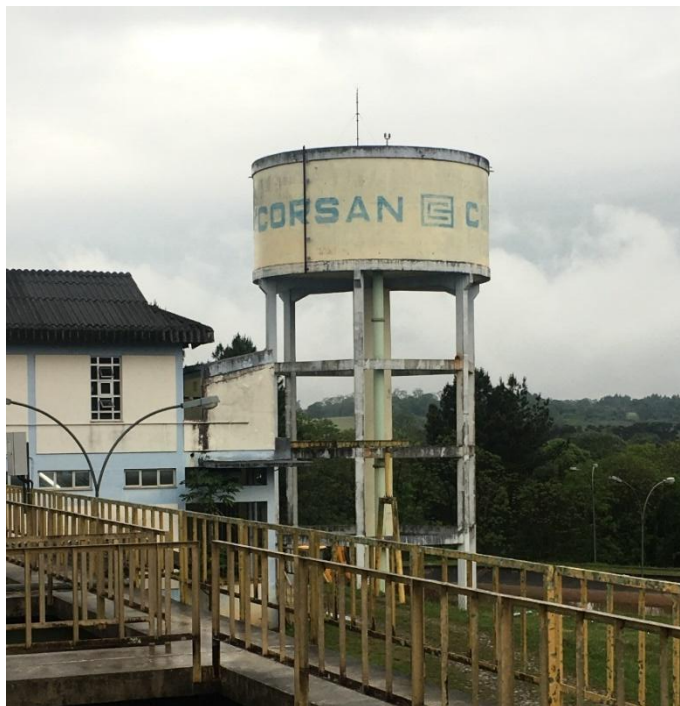
Figura 20 - REL ETA 2 (250 m³).
